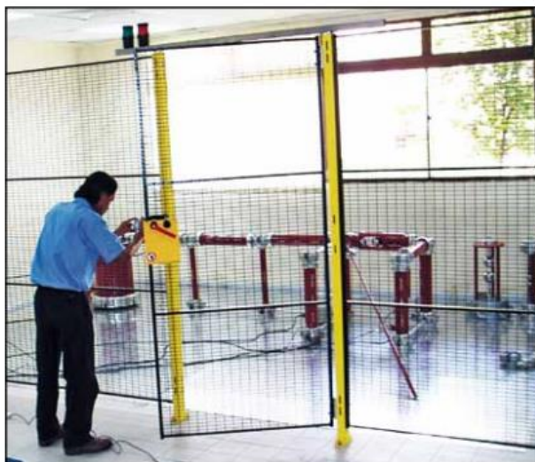
Ilustración 11. Jaula de seguridad del laboratorio de Alta Tensión
