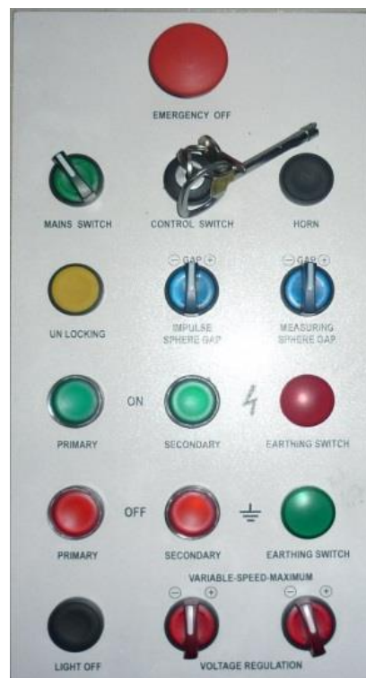
Ilustración 52. Panel de control
