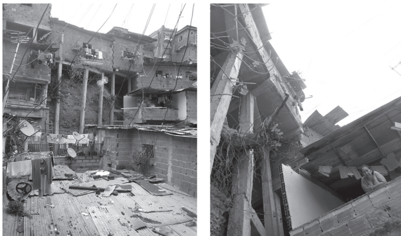
Fotos 2 y 3 Viviendas en condición de muy alto riesgo en el barrio SR
