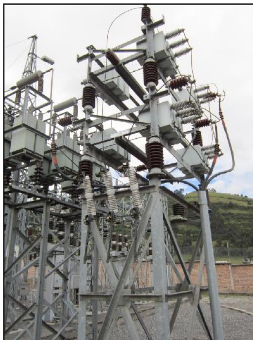
Figura 2.16. Banco de Capacitores 1 - S/E E. Espejo 29 .
