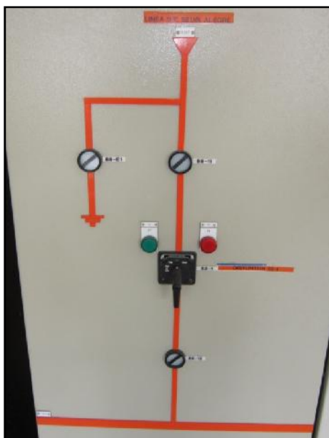
Figura 2.28. Tablero de control – L/T Selva Alegre - S/E E. Espejo 46
