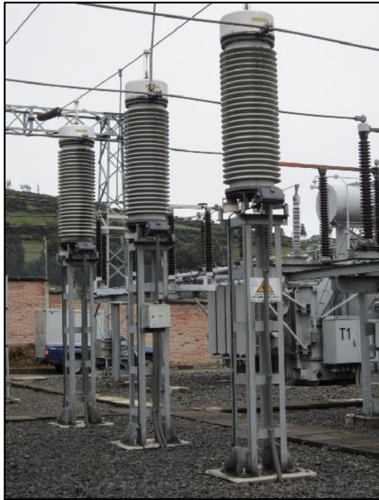
Figura 2.10. Transformador de Potencial – Barra 138kV. S/E Eugenio Espejo 16
