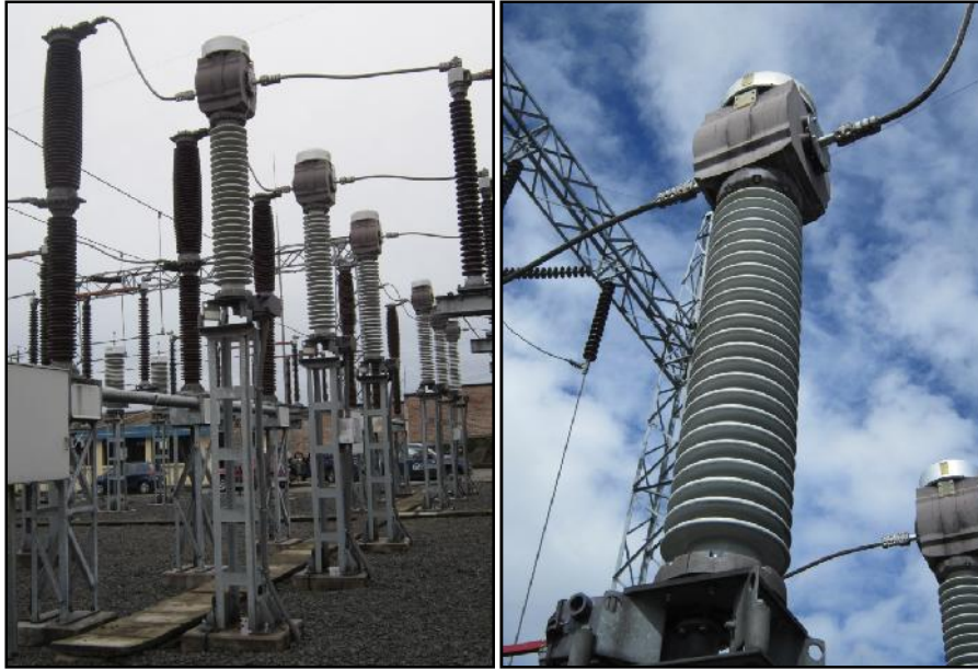
Figura 2.11. Transformador de Corriente – 138kV. Subestación Eugenio Espejo 18
