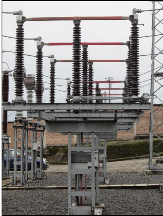
Figura 2.7. Seccionadores 89-11 y 89-21 (138kV) S/E Eugenio Espejo 9
