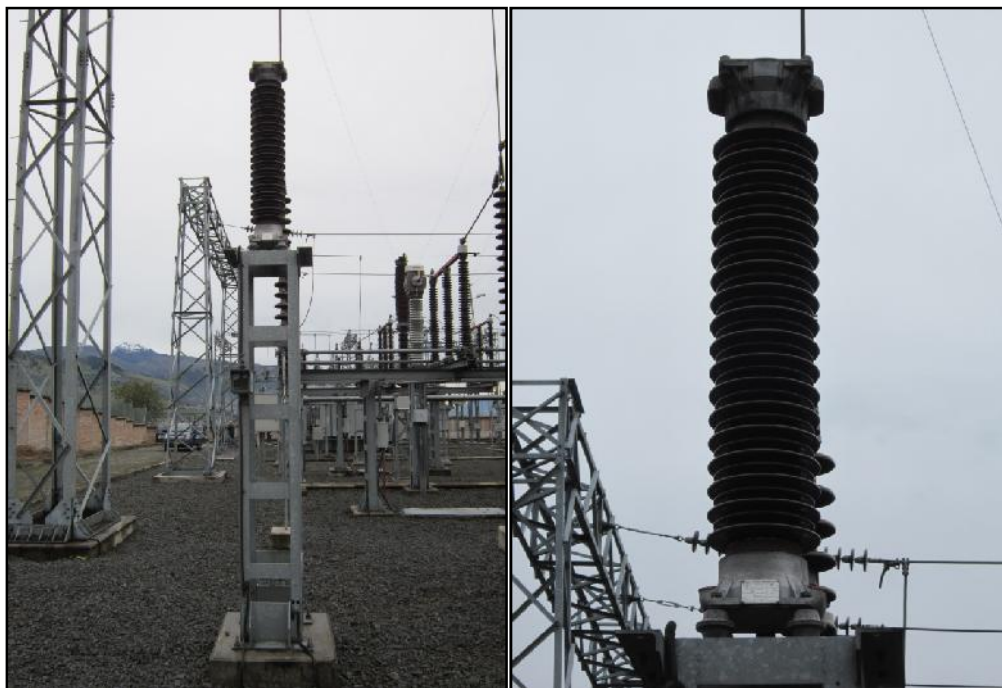
Figura 2.8. Pararrayos (138kV) Subestación Eugenio Espejo 12
