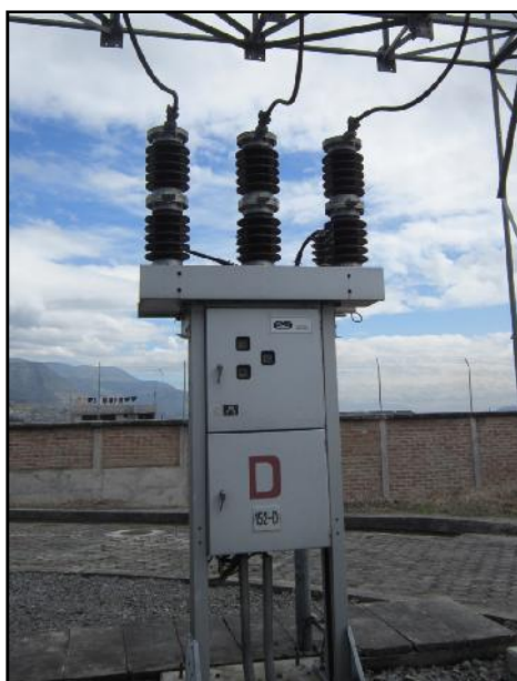
Figura 2.14. Disyuntor 152-D (23kV) Subestación Eugenio Espejo 24
