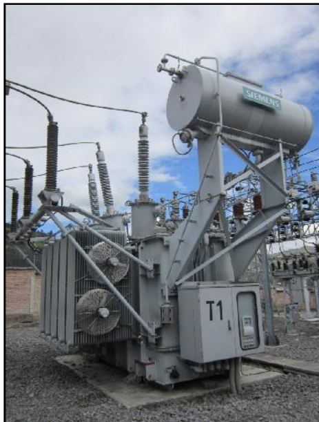
Figura 2.12. Transformador de Potencia T1 – 138/23kV – 33 MVA. S/E E. Espejo 19
