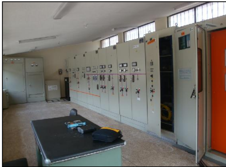
Figura 2.17. Cuarto de Control – S/E Eugenio Espejo 30
