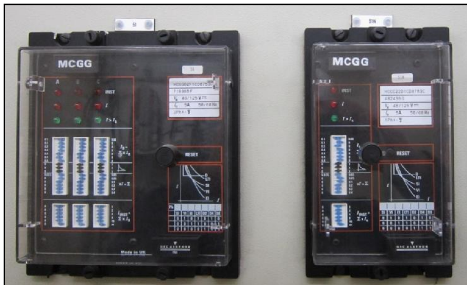
Figura 2.23. Protección Sobrecorriente Alimentación 1 (23 kV) – S/E Eugenio Espejo 39
