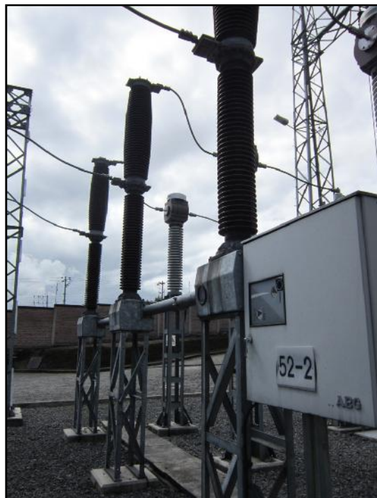
Figura 2.6. Disyuntor 52-1 (138kV) Subestación Eugenio Espejo 8
