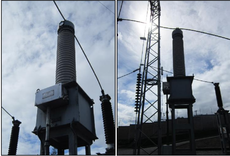
Figura 2.9. Divisor Capacitivo (138kV) Subestación Eugenio Espejo 14
