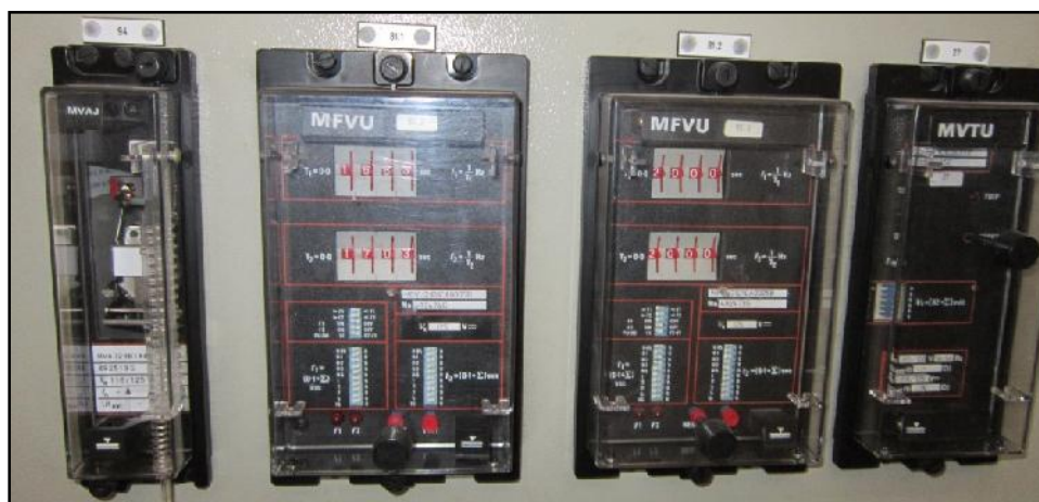
Figura 2.24. Relé de Disparo (94), Baja Frecuencia (81-1 y 81-2) y Mínima Tensión (27) Alimentación 1 (23 kV) – S/E Eugenio Espejo 40
