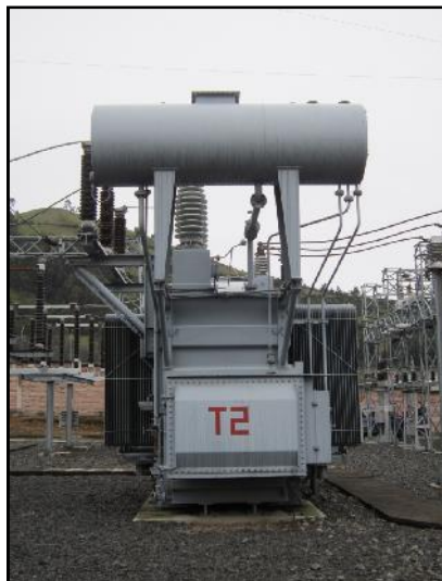
Figura 2.13. Transformador de Potencia T2 - S/E Eugenio Espejo 21
