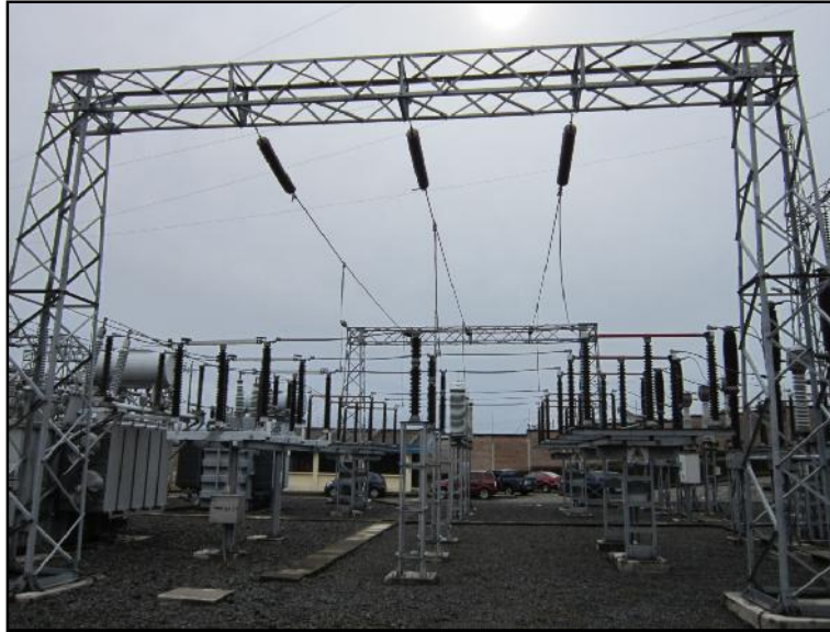
Figura 2.4. Barra 138 kV - Subestación Eugenio Espejo 4
