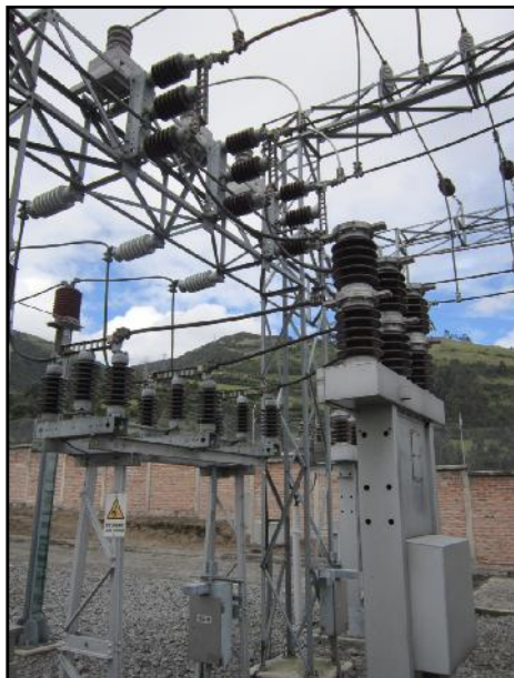
Figura 2.15. Seccionador 189-11 (horizontal) y seccionador 189-12 (vertical) Alimentación 1 en 23 kV- S/E E. Espejo 27 .
