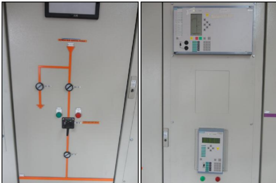
Figura 3.70. Tablero antiguo (izq.). Tablero nuevo de IED L/T Sta. Rosa) (der). 147
