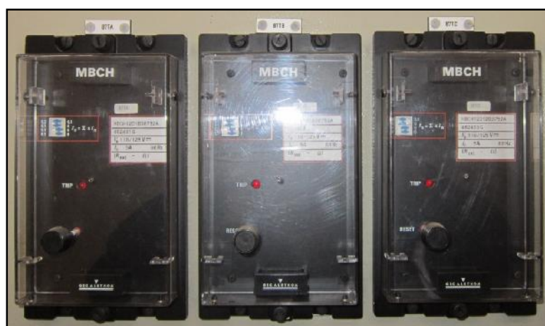
Figura 2.22. Protección Diferencial de Transformador – T2 - S/E Eugenio Espejo 37
