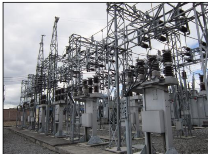
Figura 2.5. Barra 23 kV - Subestación Eugenio Espejo 5
