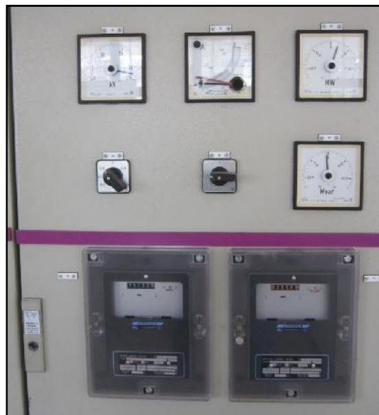
Figura 2.27. Tablero de medición – L/T Selva Alegre - S/E E. Espejo 45
