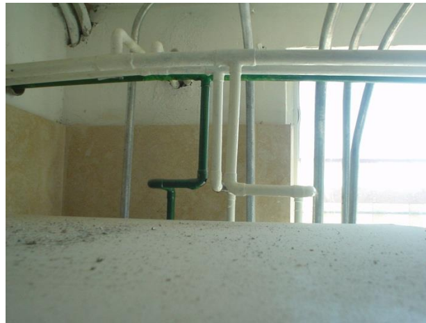
FOTO 19. Línea secundaria de vacío con conexión a tomas de pared sección norte. 3
