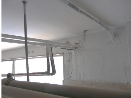
FOTO 10. Tipos de conexión de tubería de cobre de 1/2" a tomas de pared. 1
