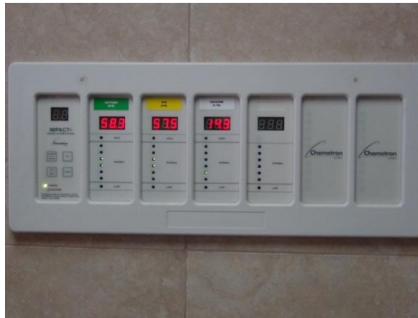
FOTO 09. Conjunto da alarmas integradas CHEMETRON. 2
