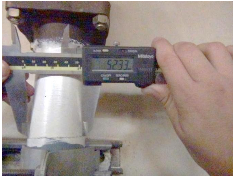
FOTO 02. Dimensión de tubería de cobre a la succión. 2
