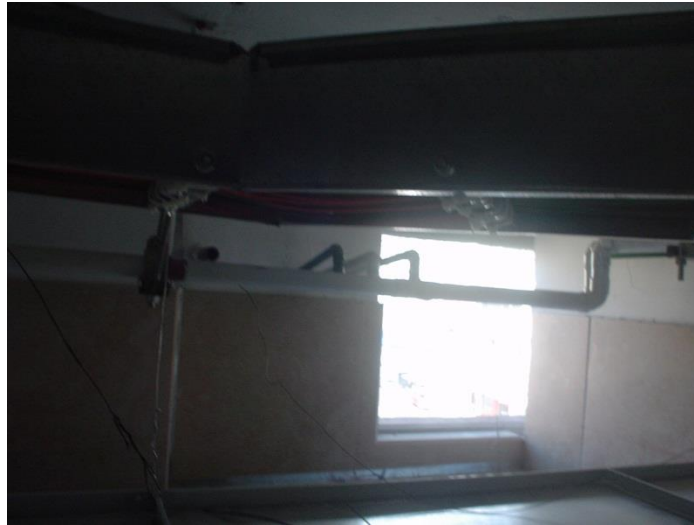
FOTO 18. Línea troncal de vacío sección norte. 2
