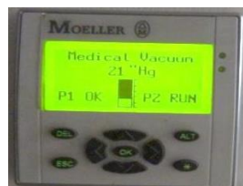
Fig.2-38. Pantalla indicando funcionamiento y nivel de vacío. 60
