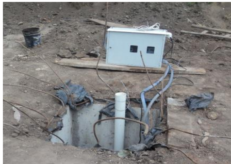
Figura 24. Equipo instalado y listo para funcionar
