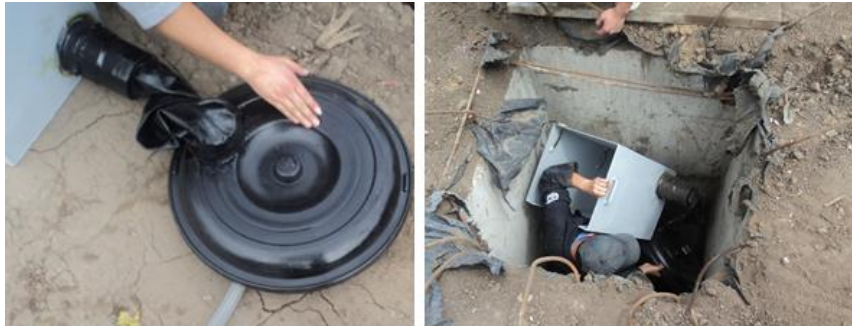
Figura 21. Tapa para el sellado y colocación del vertedero lugar: UPS-Q-S
