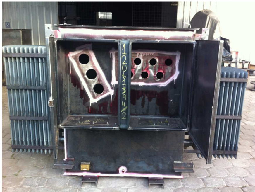
Transformador sin antes de la limpieza
