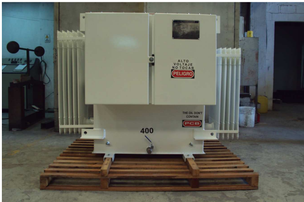
Apreciación de dimensiones de un transformador
