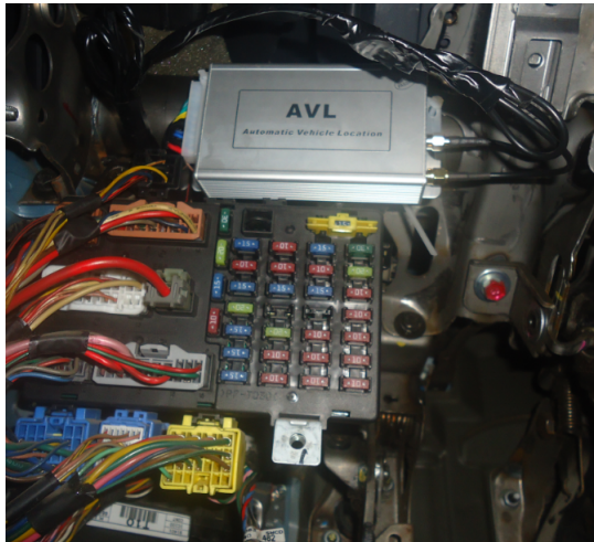
Figura 110: Lugar escogido para la instalación del equipo.
