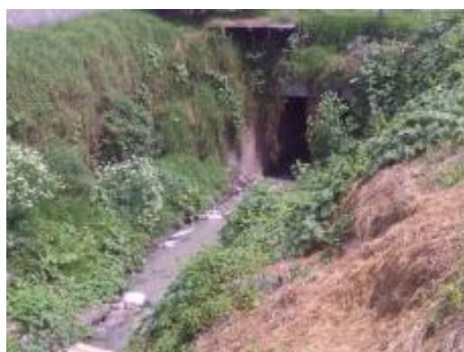
Figura 19. Descarga final de las aguas residuales de la UPS-Sur
