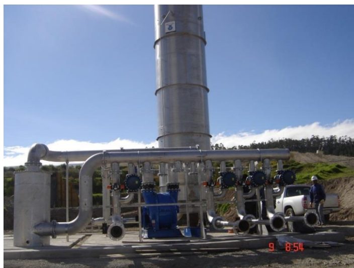
Figura 2.3: Sistema de extracción de biogás en el relleno sanitario del Inga.
