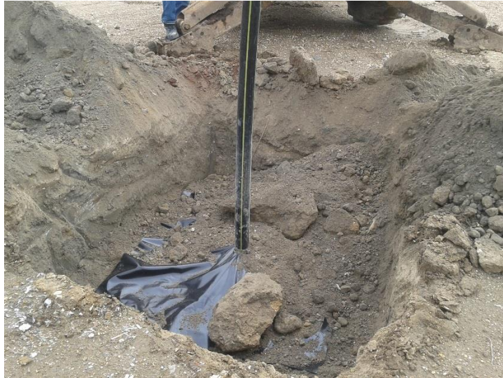
Figura 2.4: Cabeza de pozo de extracción de biogás en el RS del Inga.
