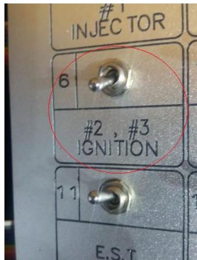
Figura 32. Panel de control de la bobina 2-3 desconectada. Fuente: Autores
