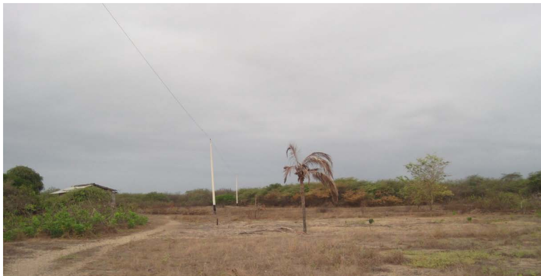
FOTOGRAFÍA 3.6.- Servicio de Energía Eléctrica.
