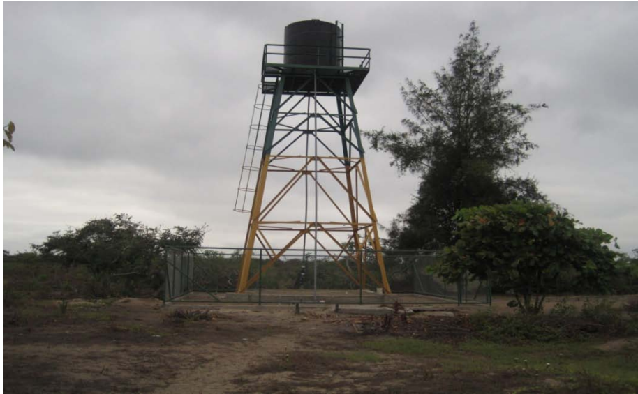
FOTOGRAFÍA 3.5.- Tanque elevado para la distribución de Agua Potable.
