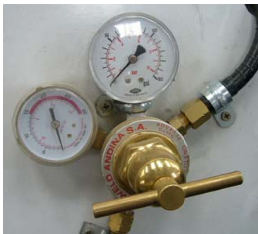
Fig 2.13 Válvula de paso de gas
