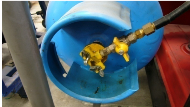
Fig 2.10 Depósito de gas
