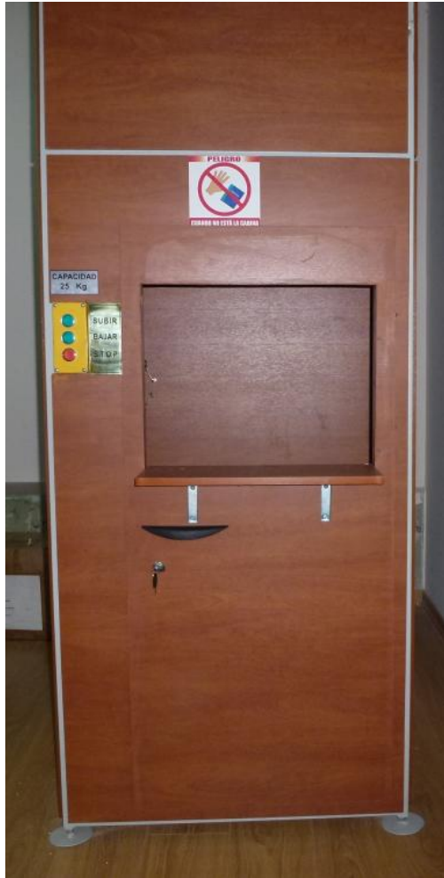
Cabina de equipo uno en subsuelo
