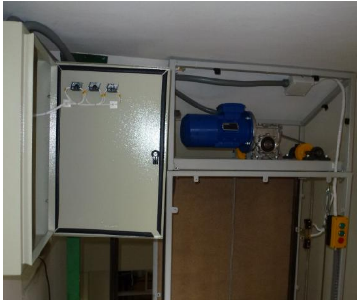
Equipo dos instalado junto con su tablero de control eléctrico
