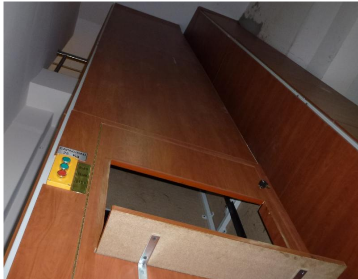
Equipos en Biblioteca del Campus El Girón de la Universidad Politécnica Salesiana, Sede Quito.
