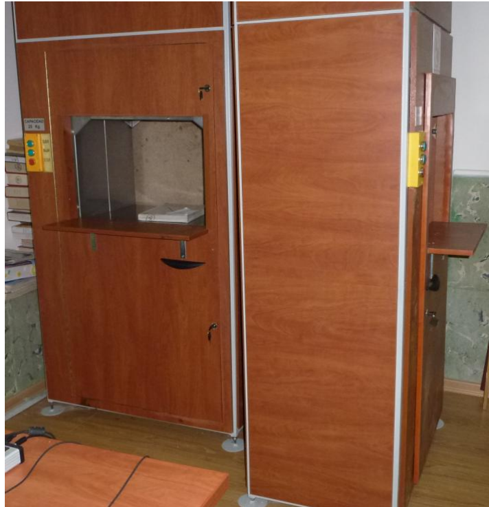
Cabinas de los equipos en subsuelo
