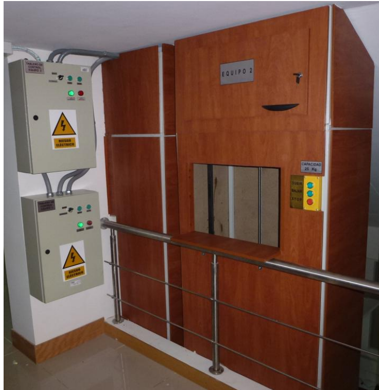
Cabina y tableros de control en planta baja
