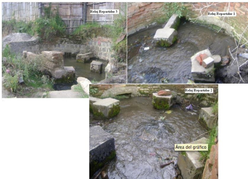
Foto 2. Relojes Repartidores del Canal 2 de la Acequia los Condueños, en la en el balance hídrico para riego en la microcuenca del río Blanco. Cayambe – Ecuador. 2009
