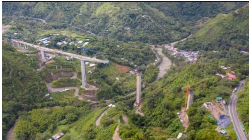
Figura 38 Construcción Vía 4G de Interconexión con El Túnel de La Línea. Cajamarca –Tolima
