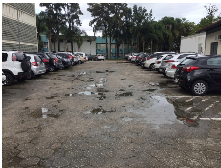
Figura 3.1 – Pavimento com poças de água após eventos de chuva
