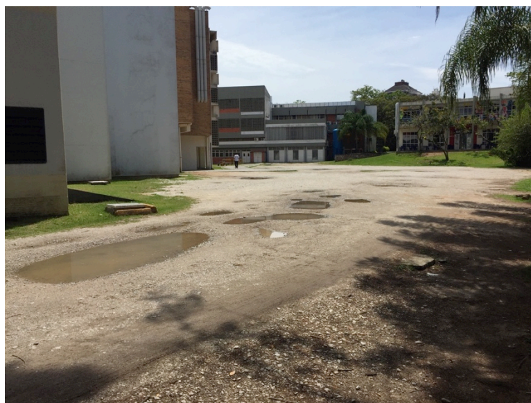
Figura 3.2 – Buracos e poças de água após chuvas intensas
