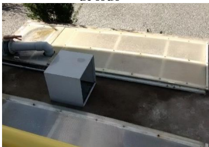
Figura 55: Tanque de acúmulo de lodo
