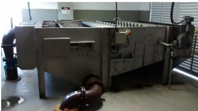
Figura 30: Adensador de lodo mecanizado em ambiente acusticamente isolado.
