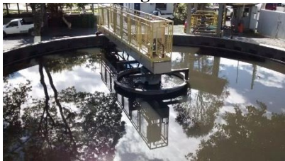
Figura 53: Decantador secundário com homogeneizador
