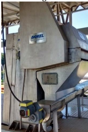
Figura 17: Sistema de Gradeamento Mecanizado com peneiramento grosseiro e fino.
