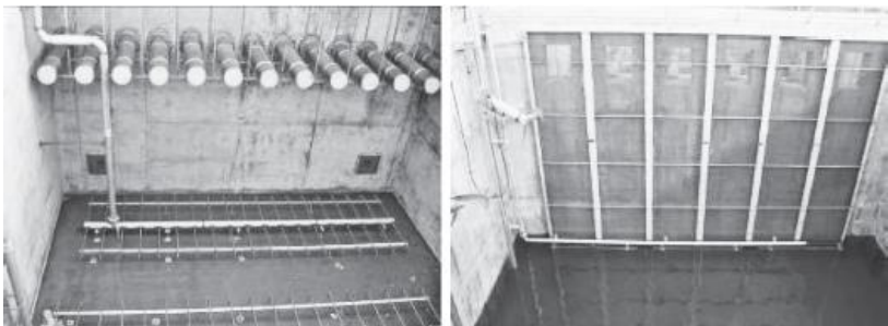
Figura 7: Grades de retenção dos meios-suporte em reator MBBR
