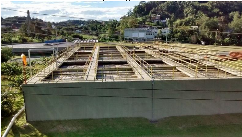
Figura 22: Tanques de aeração do sistema de lodos ativados aeração prolongada
