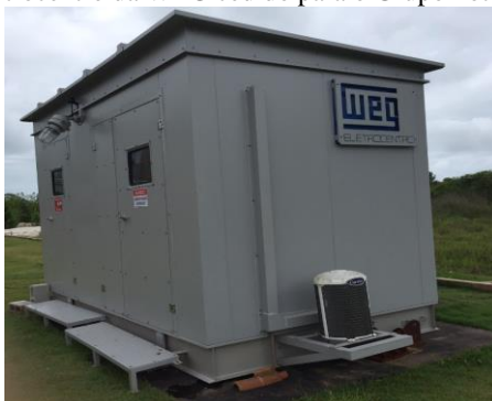
Figura 94 – Eletrocentro da WEG cedido para o Grupo Fotovoltaica UFSC
