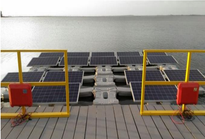
Figura 70 – Usina de flutuadores com módulos fotovoltaicos no lago de hidrelétrica
