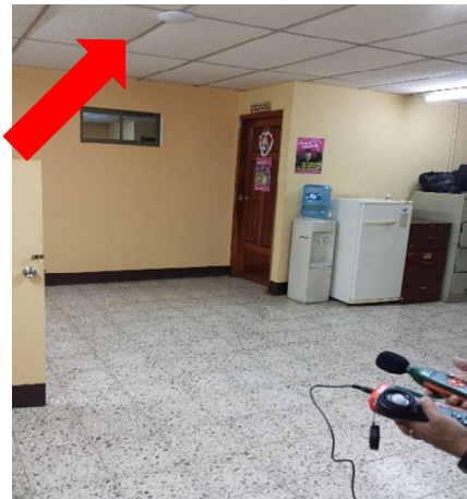
Foto 9. Alarma contra incendios
