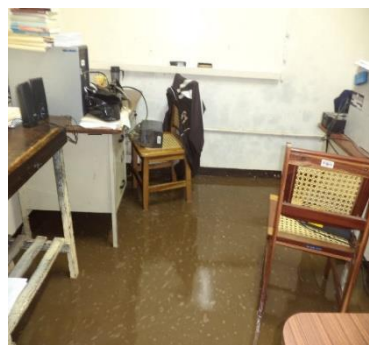
Imagen N° 21. Afectación por lluvia departamento de comunicación.
