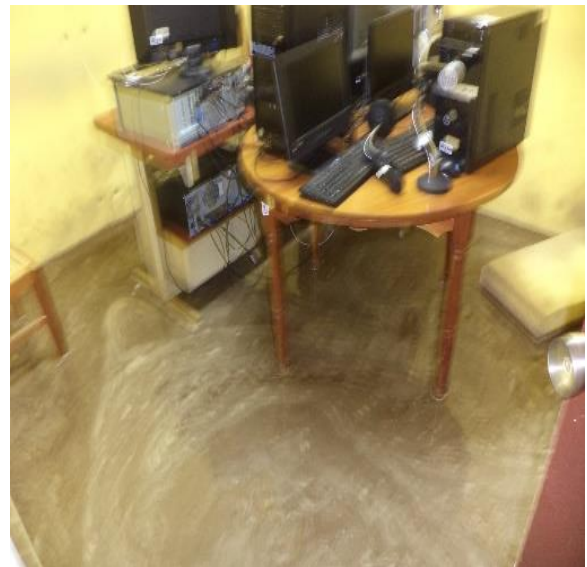
Imagen Nº 27. Afectación por la lluvia. Fuente propia.
