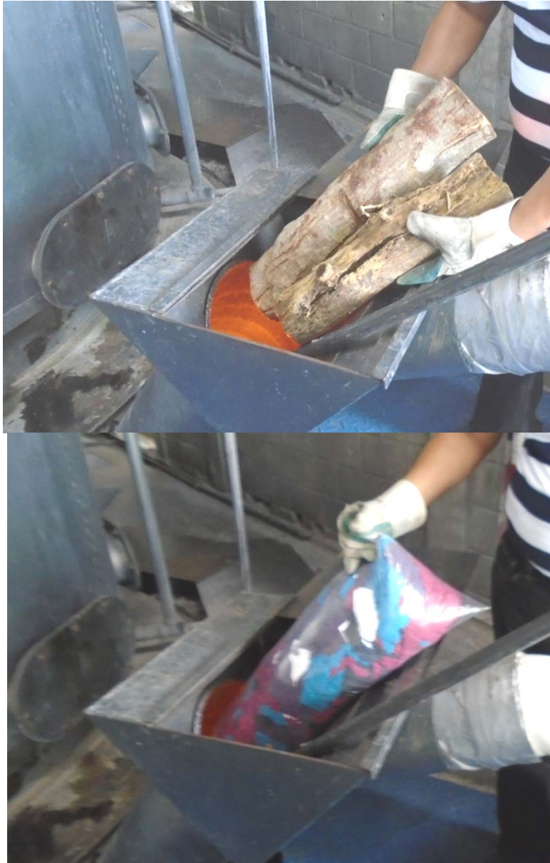
Ilustración 5 Alimentación de Caldera de Biomasa
