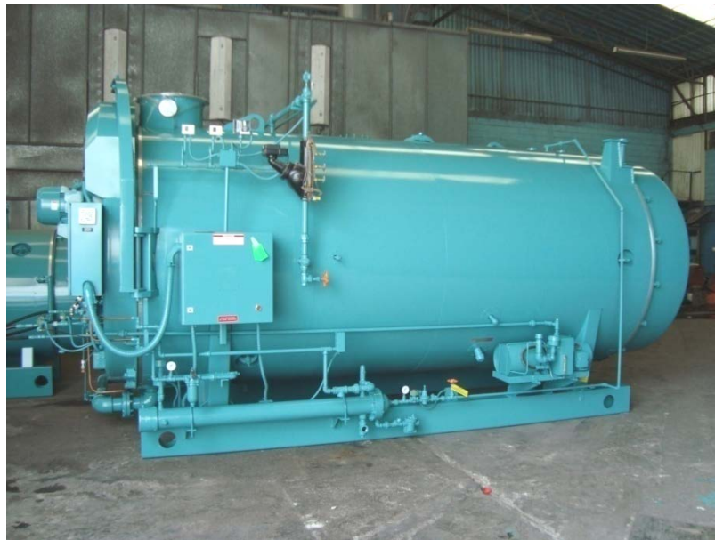
Ilustración 6 Maquina Actual (Caldera de Bunker)
