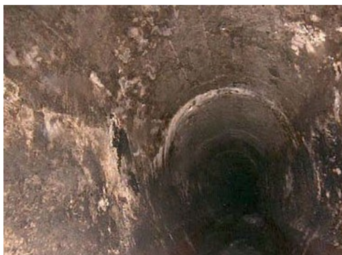
Obr. 11 Síranová korózia na potrubí [23]
