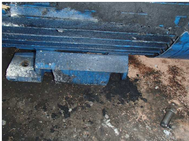
Obrázek 13 Elektromotor čerpadla 80-CV-10
