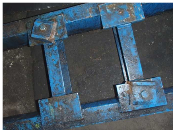
Obrázek 14 Utržené patky na základovém rámu
