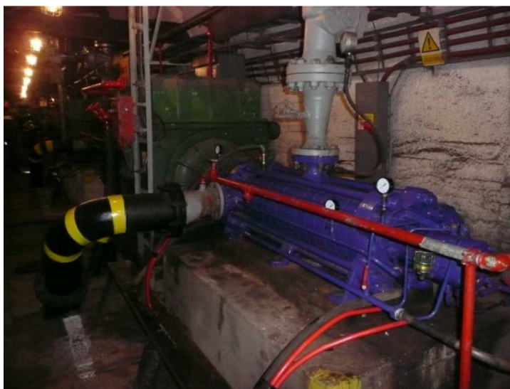
Obrázek 29 Čerpadlo s el. motorem v čerpací stanici
