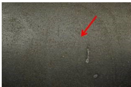
Obrázek č. 59 - Nedostatečně provedené otryskávání – výskyt korozních produktů oceli (červená rez)
