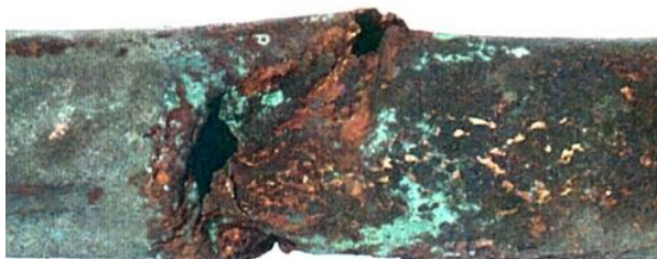
Obrázek č. 31 – Koroze trubky rozvodu plynu v půdě [16]
