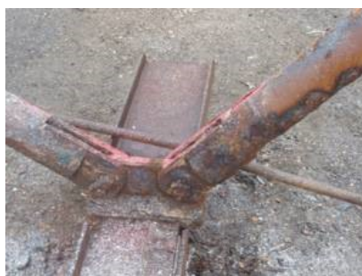
Obrázek č. 29 – Příklad atmosférické koroze [14]
