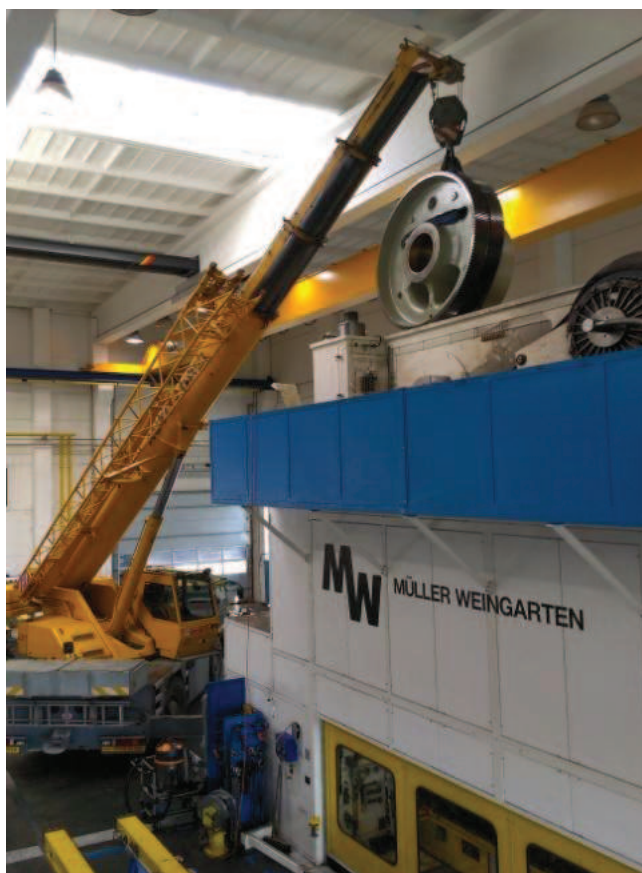
Obr. 3.4 - Demontáž lisu po nehodě
