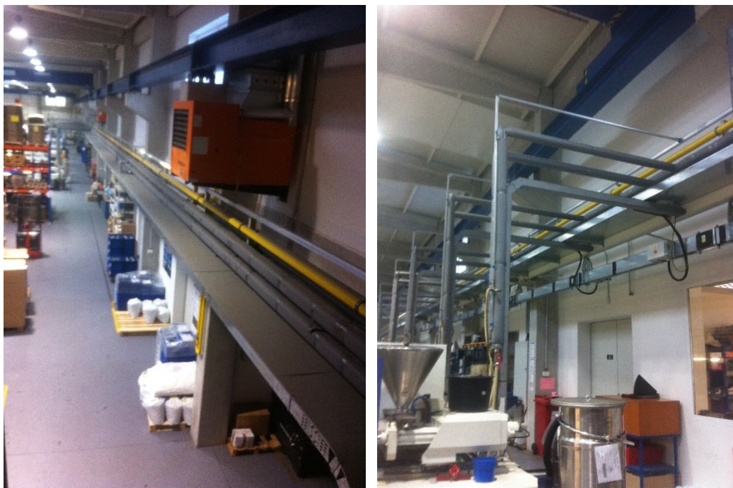
Obr. 7 Rozvod potrubí v hale Flídr plast s.r.o.
