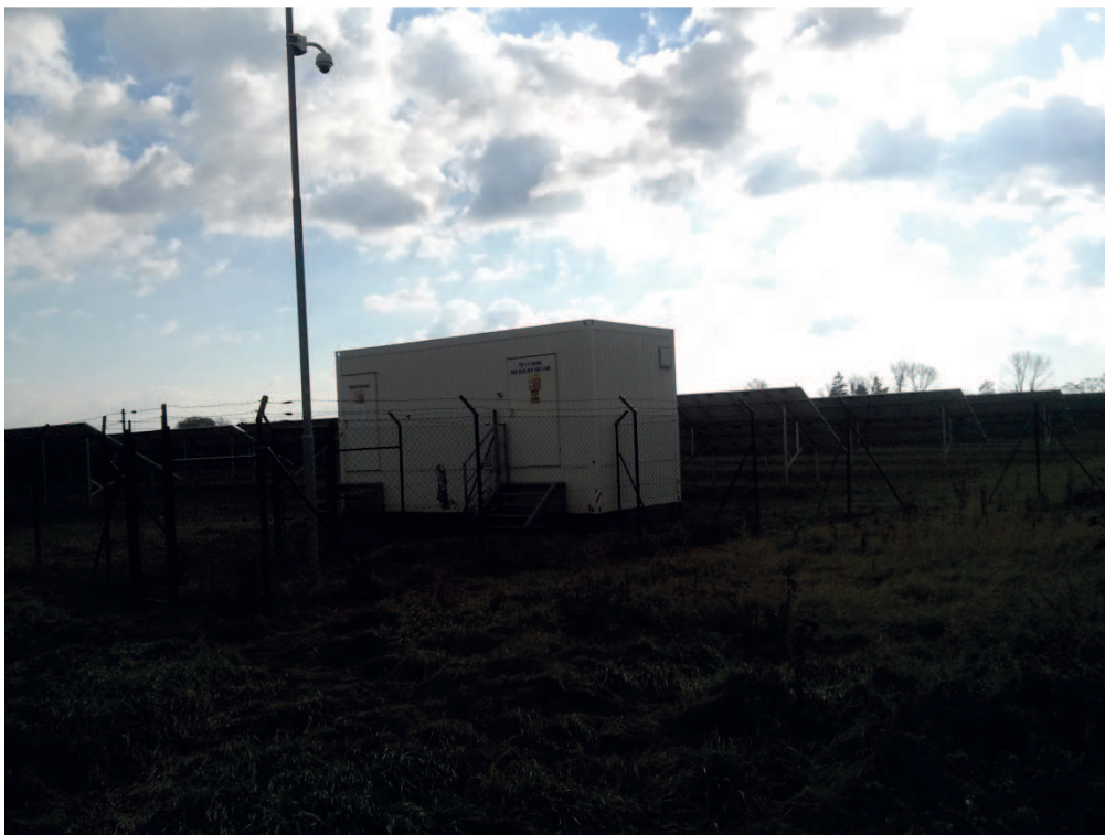
Trafostanice na jihozápadě území
