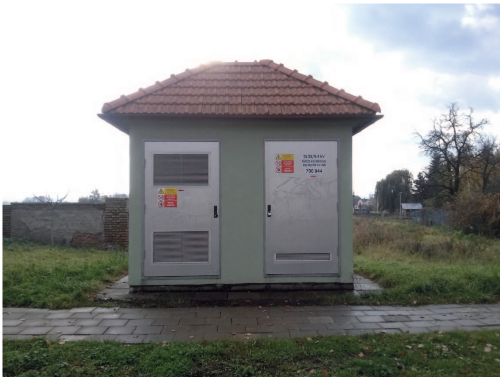
Trafostanice na severozápadě území
