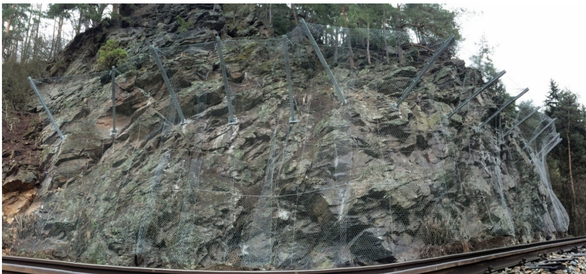
Obr. 19 Polodynamická bariéra, Sanace skalního svahu Budčice I
