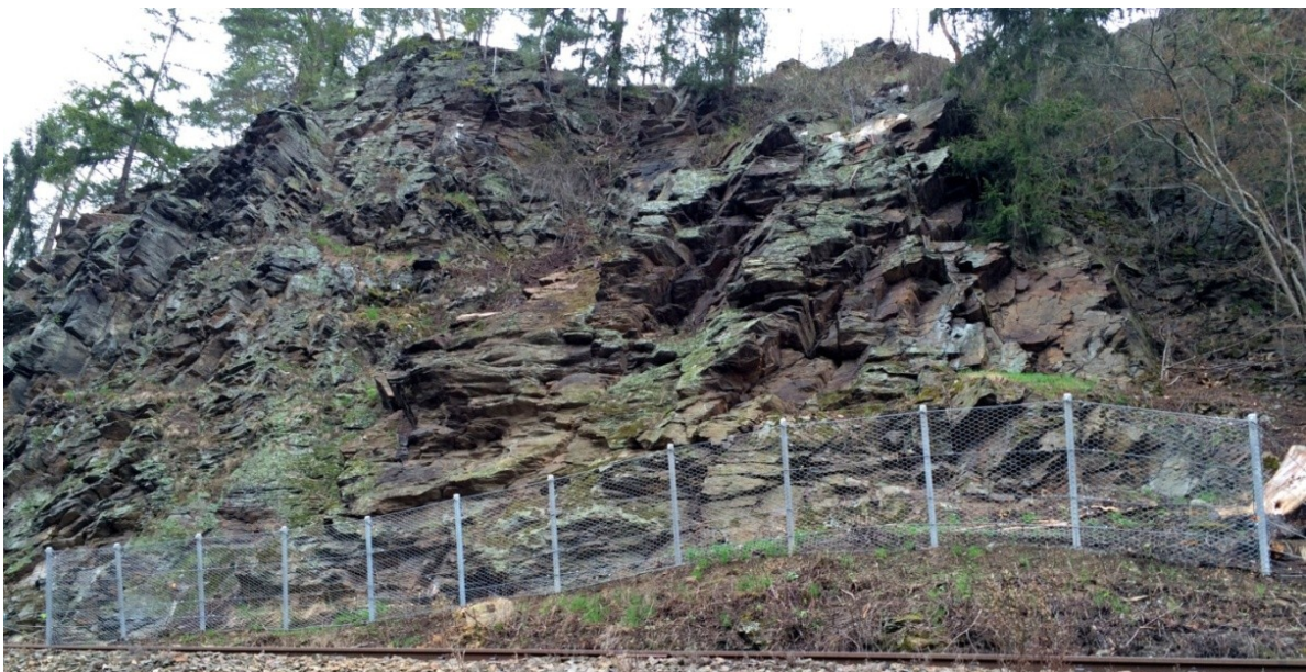
Obr. 18 Ochranné záchytné ploty, sanace skalního svahu Budčice II
