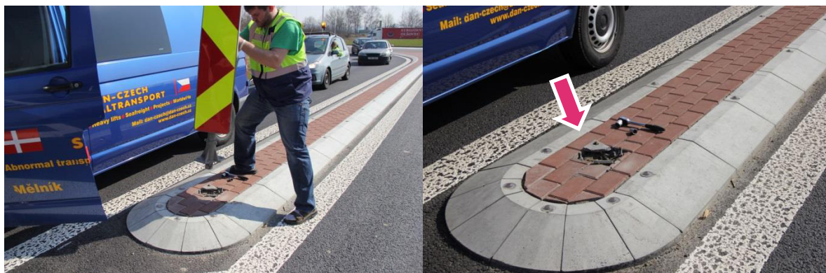
Obr. 5 Demontáž dopravní značky a následné poškození patky
