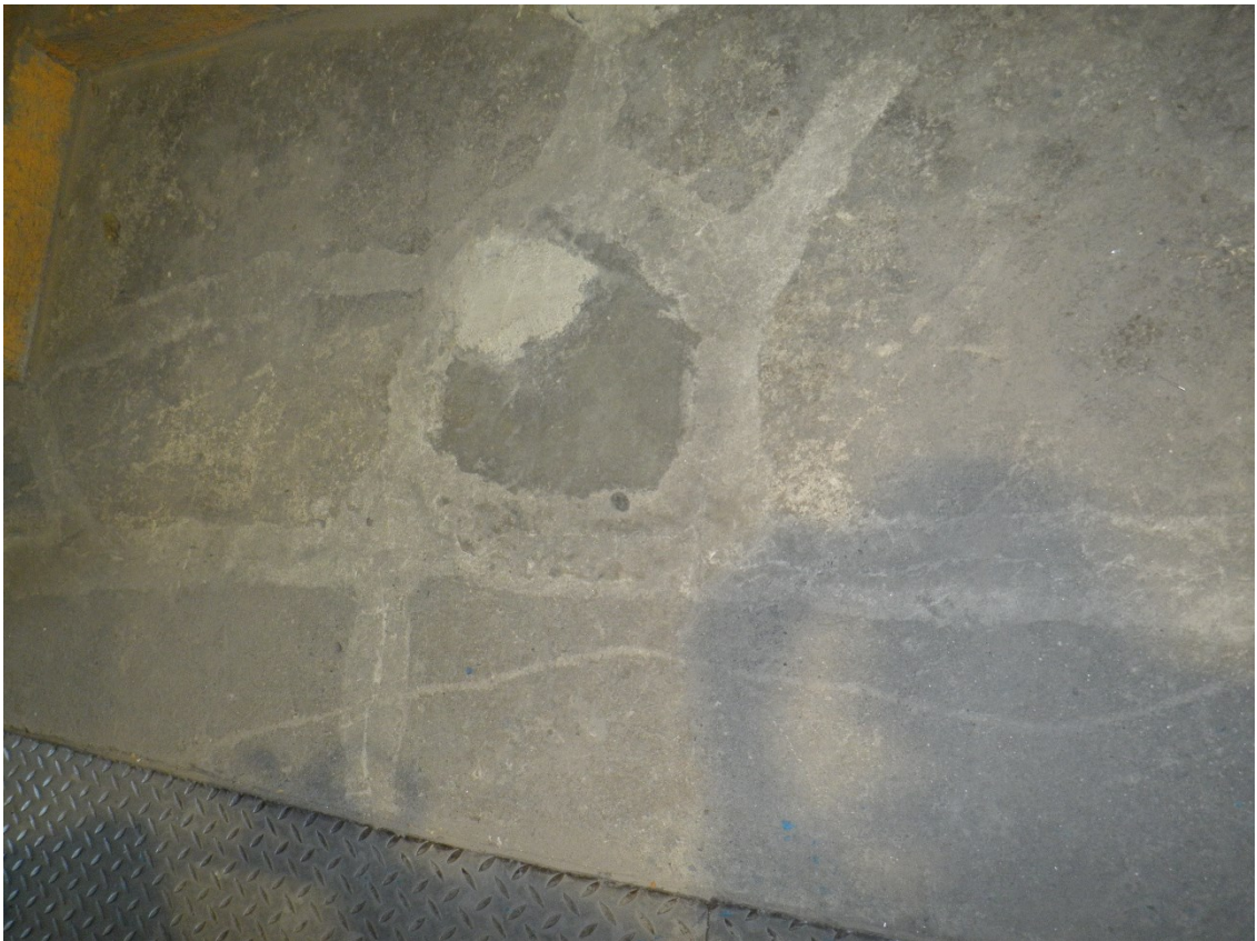
Obr. 6-8 Snímek vadného betonového základu
