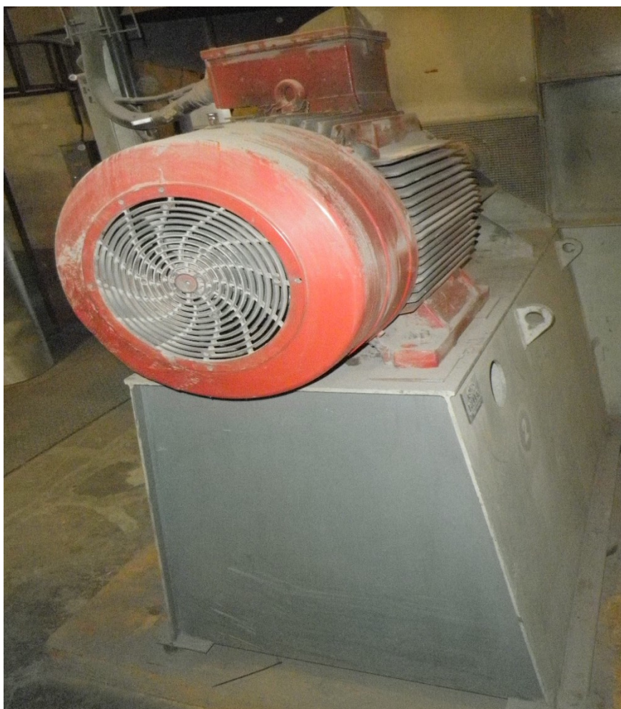
Obr. 6-4 Celkový pohled na ventilátor
