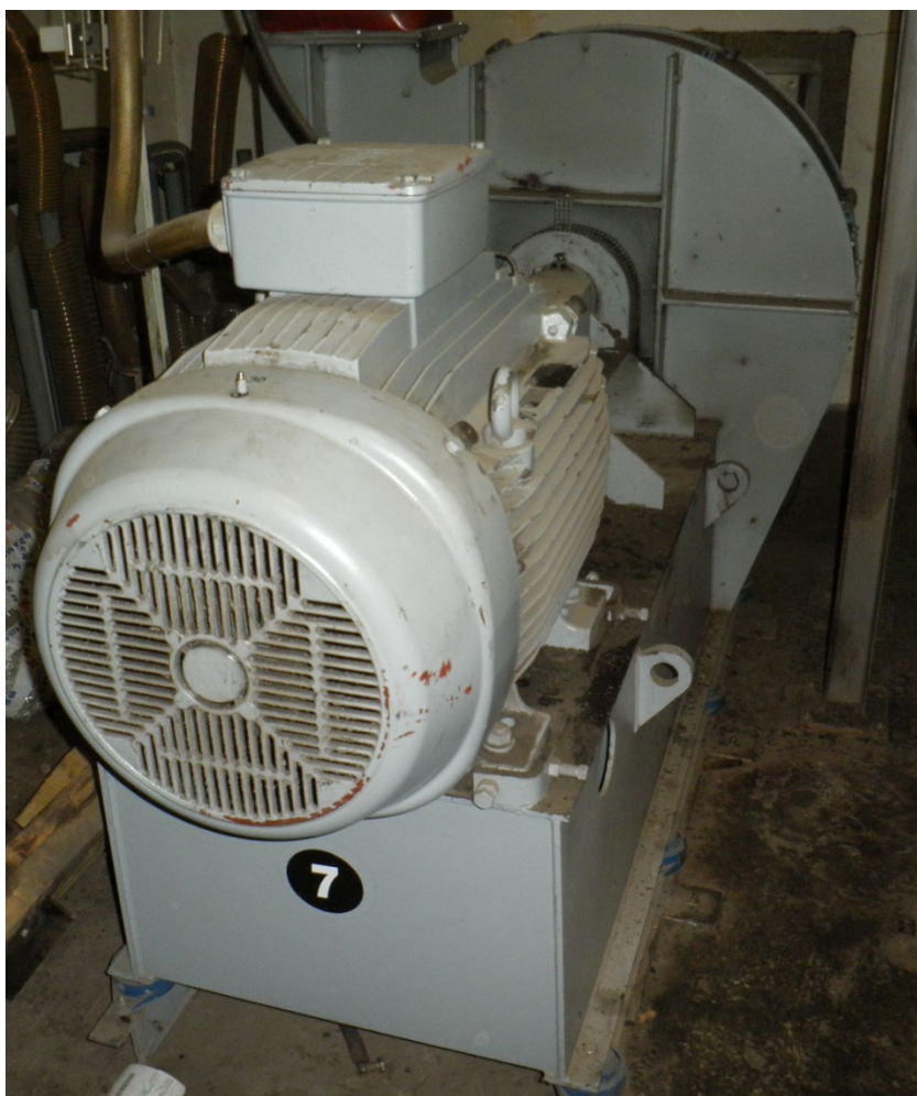
Obr. 6-9 Celkový pohled na ventilátor
