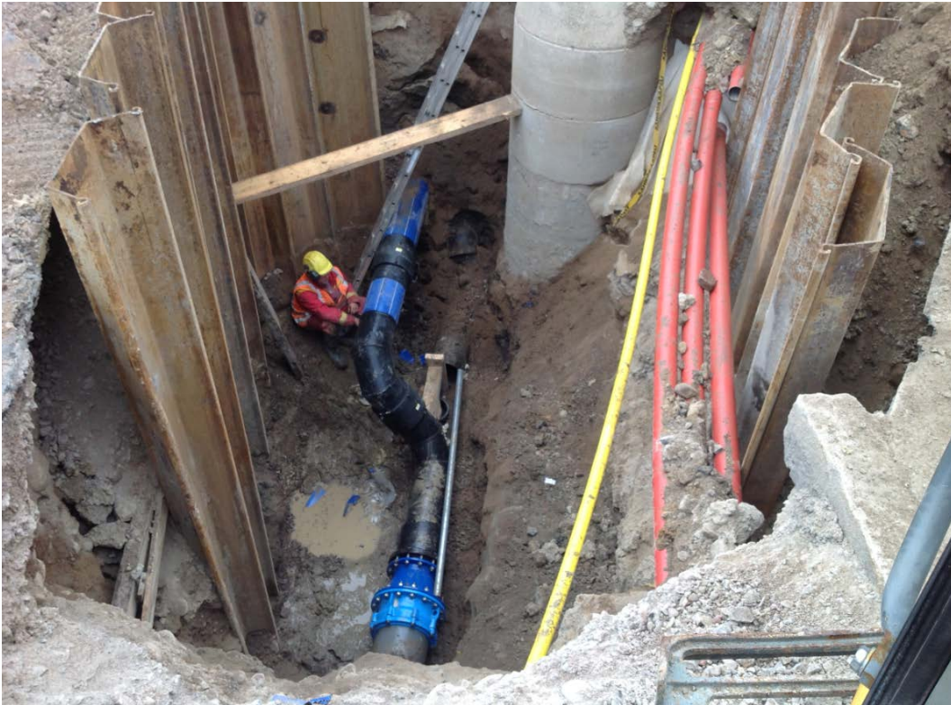
Kuva 6. Puutteellinen työturvallisuus. Ponttien välillä ei ole lainkaan poikkitukia kaivannon poikki, eikä pontteja ole lyöty tiiviisti kiinni toisiinsa eli tuentarakenne ei ole välttämättä turvallinen eikä toteutettu suunnitelman mukaan. © Sanna Rantanen
