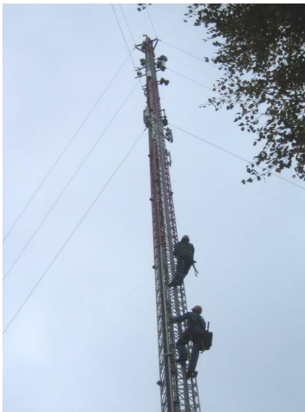
Kuva 59. Ulkoa kiivettävä masto ja huoltomiehet työssään.
