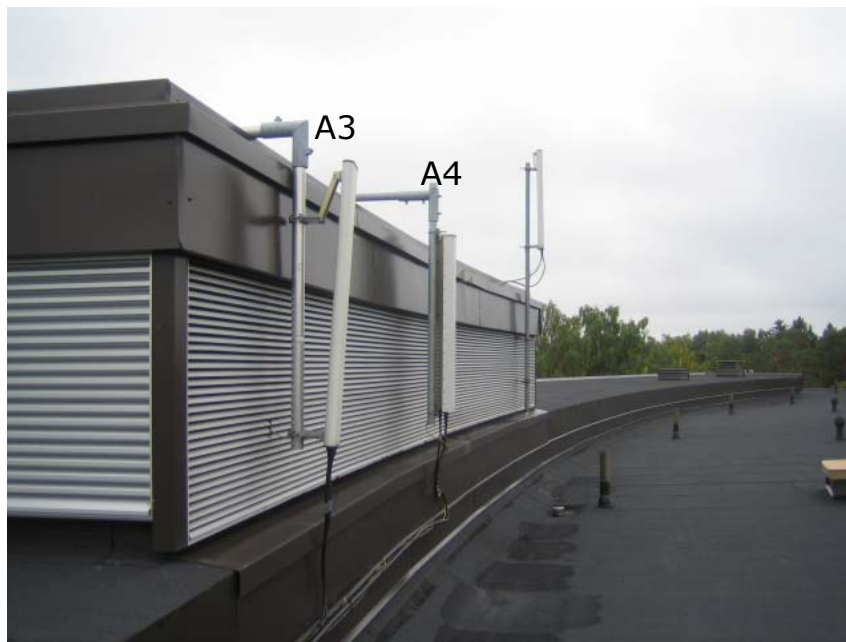
Kuva 52. Katolla olleet antennit A3 ja A4. Kolmas kuvassa näkyvä antenni oli asennettu niin korkealle, ettei siitä aiheutunut merkittäviä SM-kenttiä kattotasanteelle.
