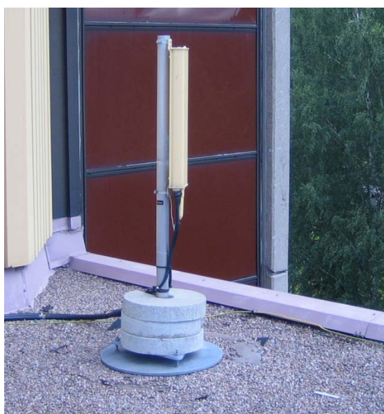
Kuva 29. Tukiasema-antenni kohteessa D.
