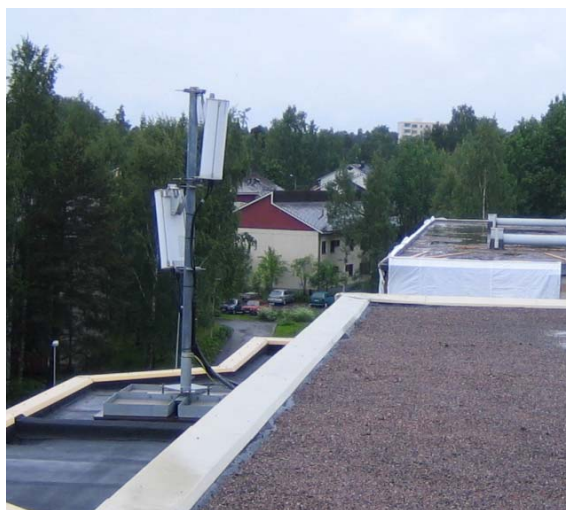
Kuva 24. Tukiaseman antennit kohteessa C.
