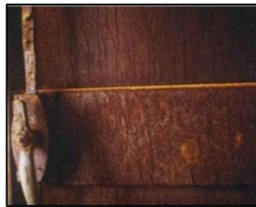
Figura I.1. Foto de puerta metálica que muestra ataque corrosivo uniforme.
