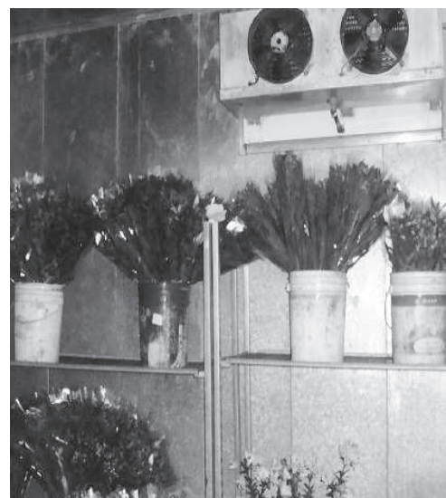
Foto 4. Interior de cámara frigorífica
