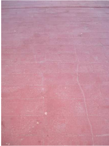
Fotografía 07: Fisura en la capa de protección
