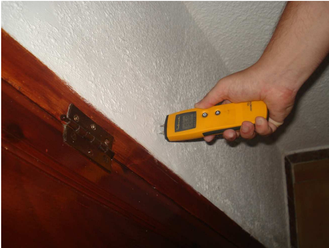
Fotografía 20: Humedad por capilaridad en pasillo, lectura 96,80% de humedad a una altura de 1,00 m
