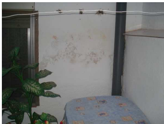
Fotografía 13: Humedades en patio
