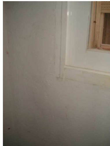
Fotografía 15: Humedad de condensación en carpintería sin rotura de puente térmico
