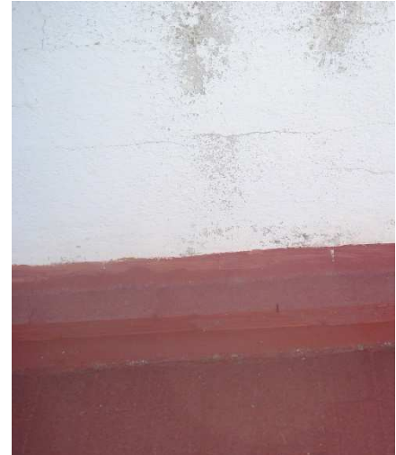
Fotografía 09: Deterioro del revestimiento del antepecho
