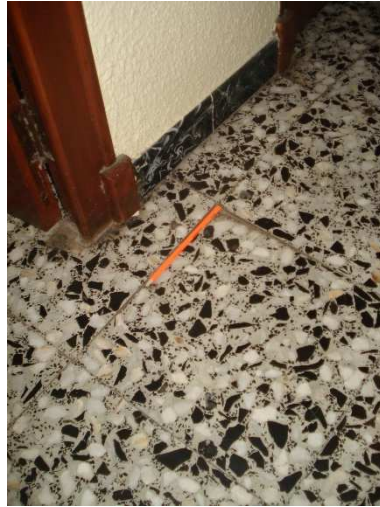
Fotografía 17: Ceja en el pavimento
