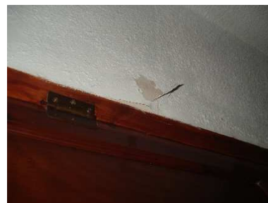
Desconchados por humedad
