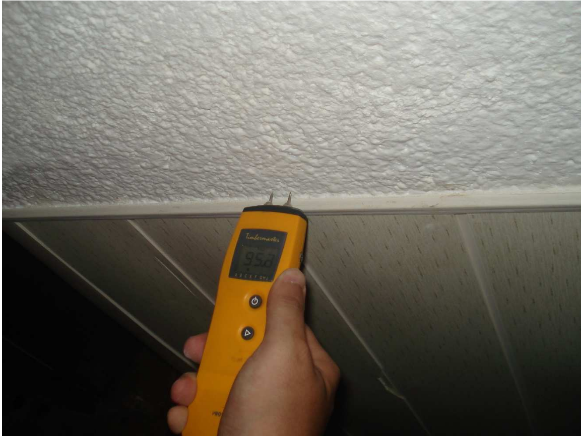
Fotografía 19: Humedad por capilaridad en pasillo, lectura 95,20% de humedad a una altura de 1,00 m
