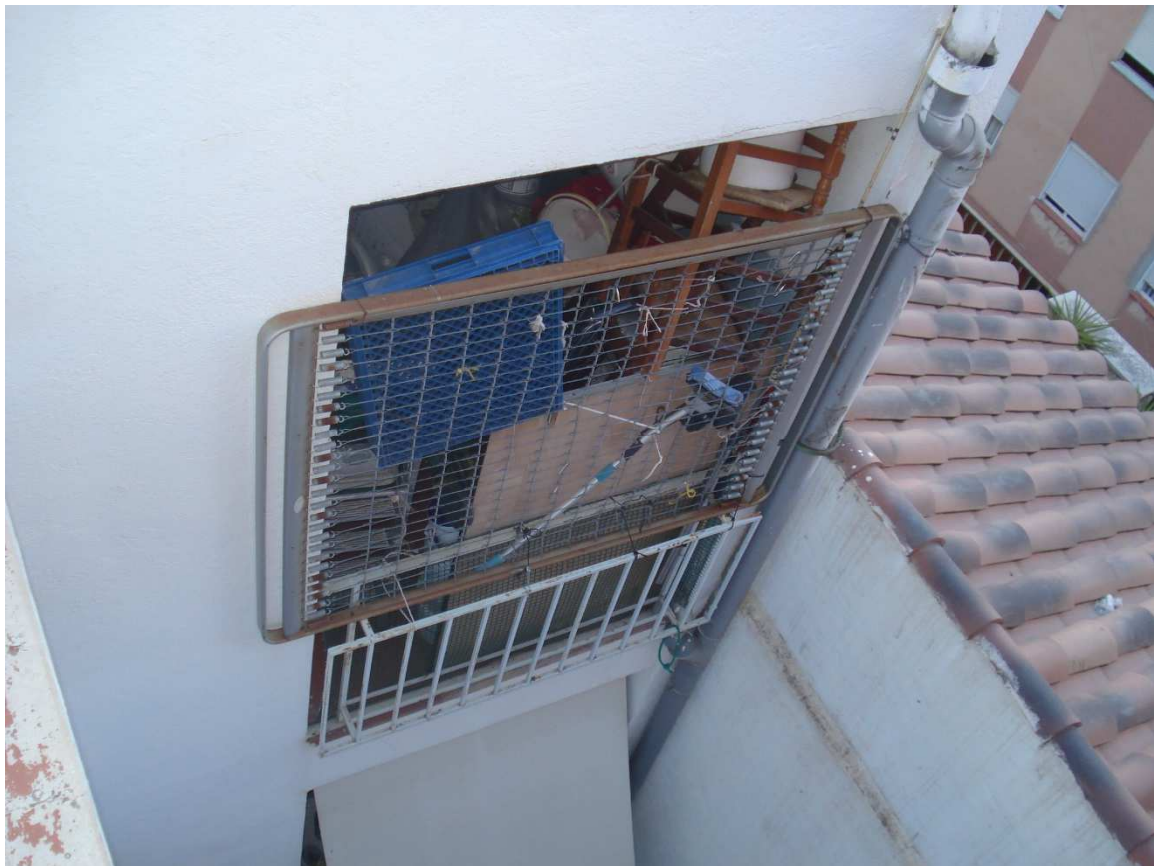
Fotografía 18: Conexión de bajante de pluviales con bajante de residuales
