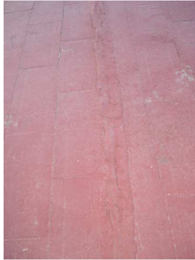
Fotografía 08: Grietas en la limatesa
