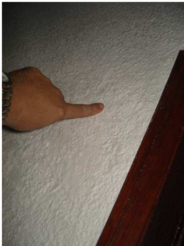
Fotografía 14: Humedad a la altura del dintel de la carpintería en vivienda de la planta baja
