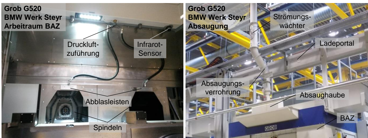
Abbildung 5.63: Arbeitsraum und Absaugvorrichtung eines untersuchten, verketteten MMS-BAZ im Pilotsystem im BMW Werk Steyr
