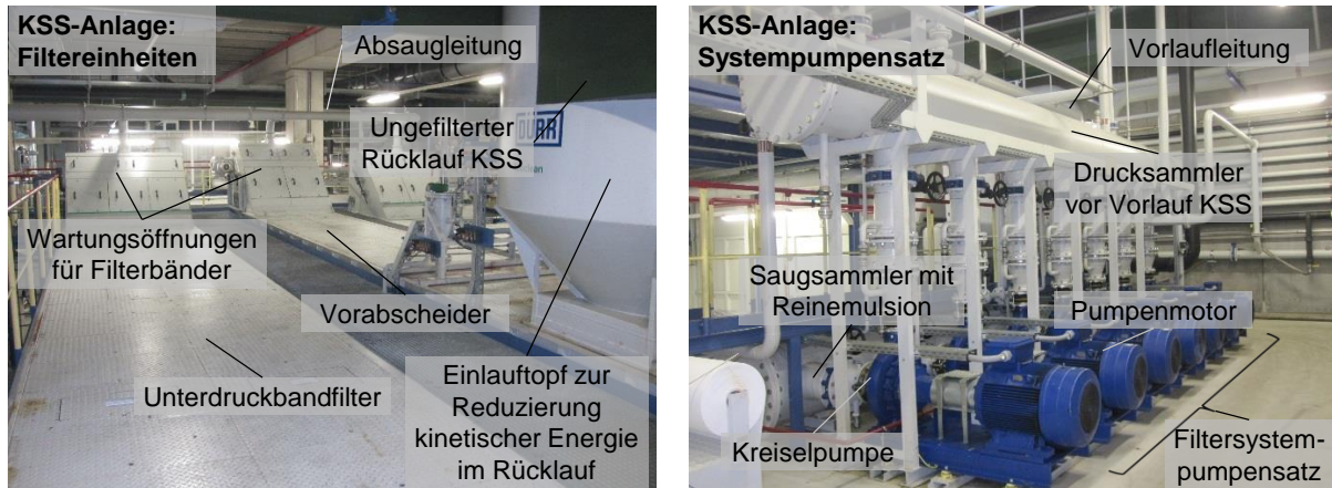
Abbildung 5.39: Untersuchte KSS-Unterdruckbandfilteranlage im BMW Werk Steyr
