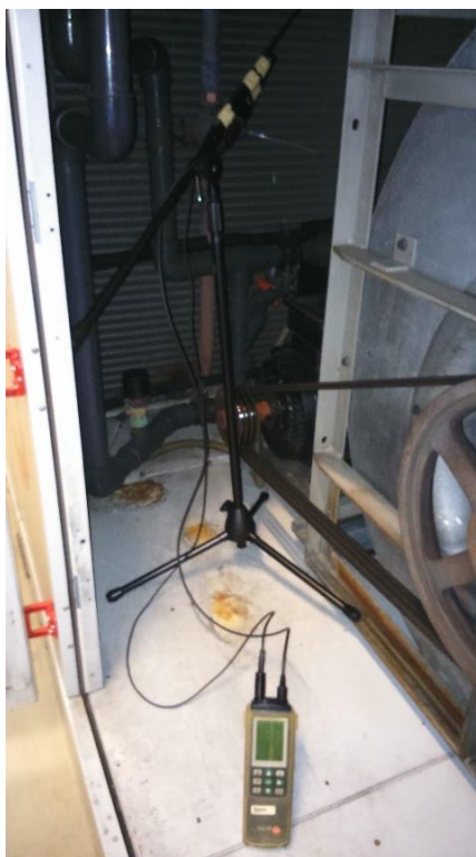
Figura 21 - Instalação do anemómetro para medições
