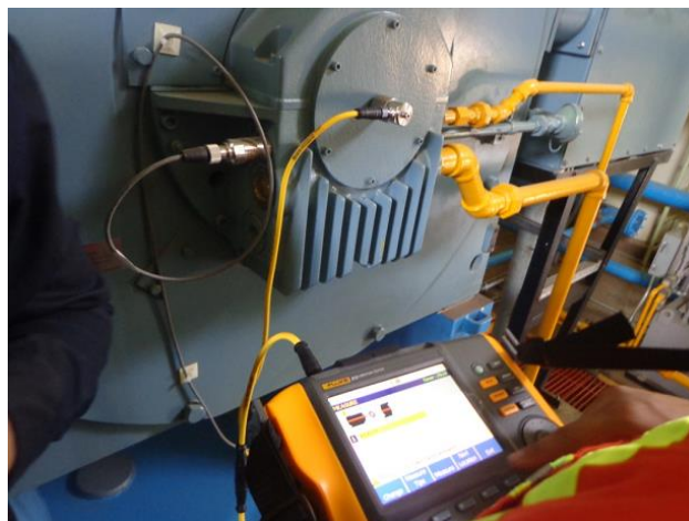
Ilustración 5: Inspección por análisis de vibraciones. [4]
