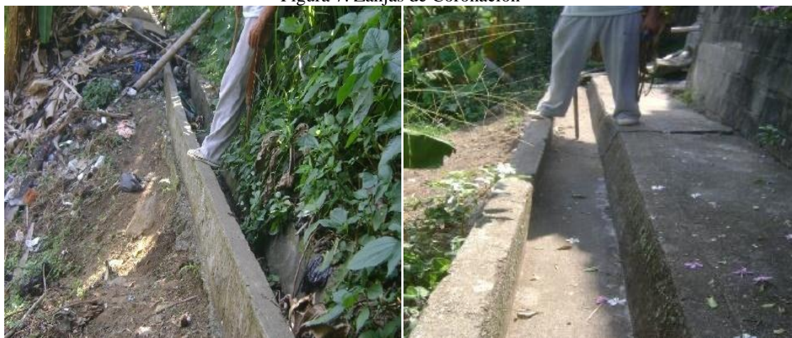
Figura 7. Zanjas de Coronación
