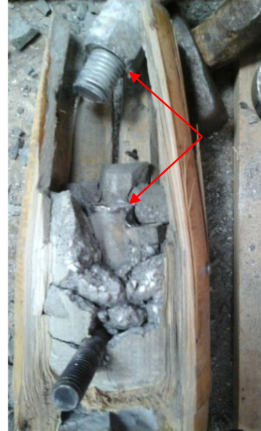
Figura 25 Soldadura del sujetador rota
