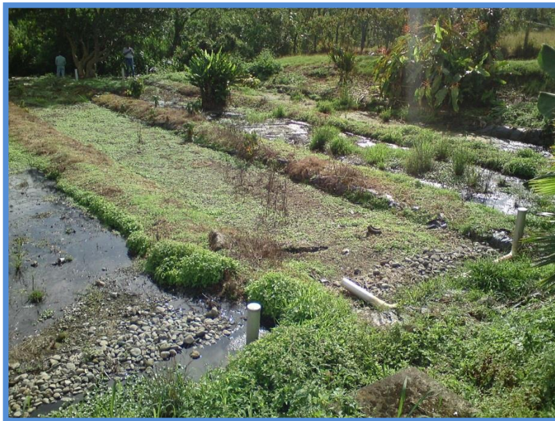
Figura 17. Estado inicial unidades de humedales – PTAR La Florida. Fuente: GIAS
