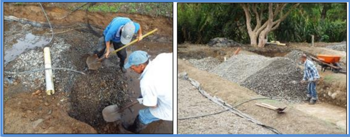
Figura 24. Limpieza de material filtrante (grava).Unidad Experimental. Fuente: GIAS
