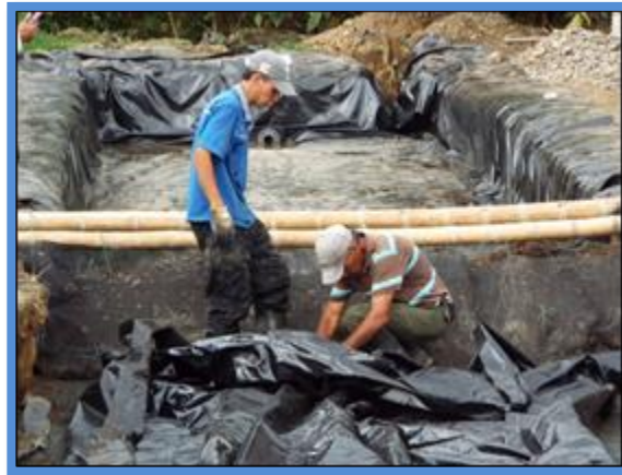
Figura 25. Construcción de dique e instalación de geovinil.enidad experimental N°4 y N°3. Fuente: GIAS
