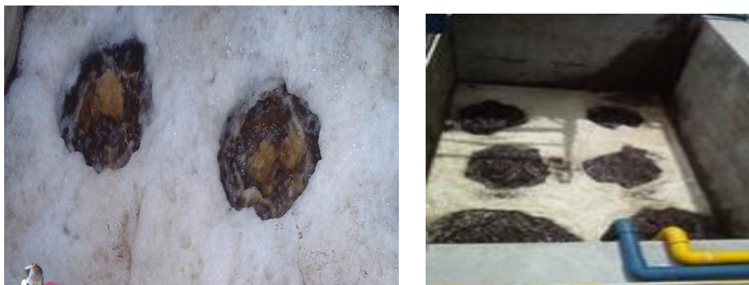
Figura 10. Difusores de aire y Tanque homogenizador.
