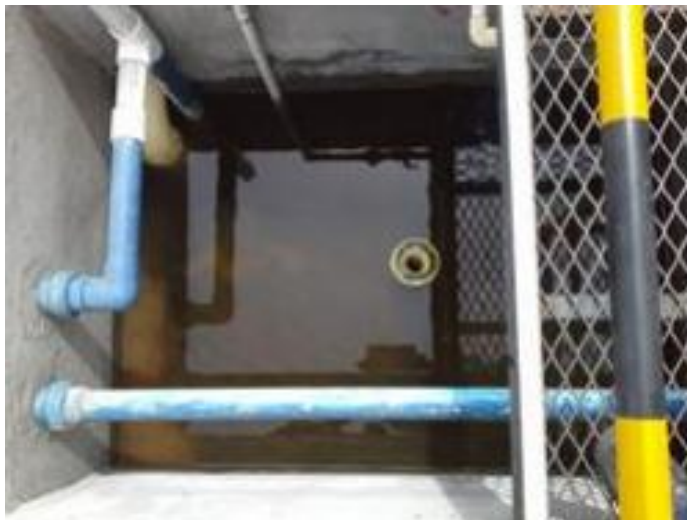
Figura 19. Unidad de clarificación.
