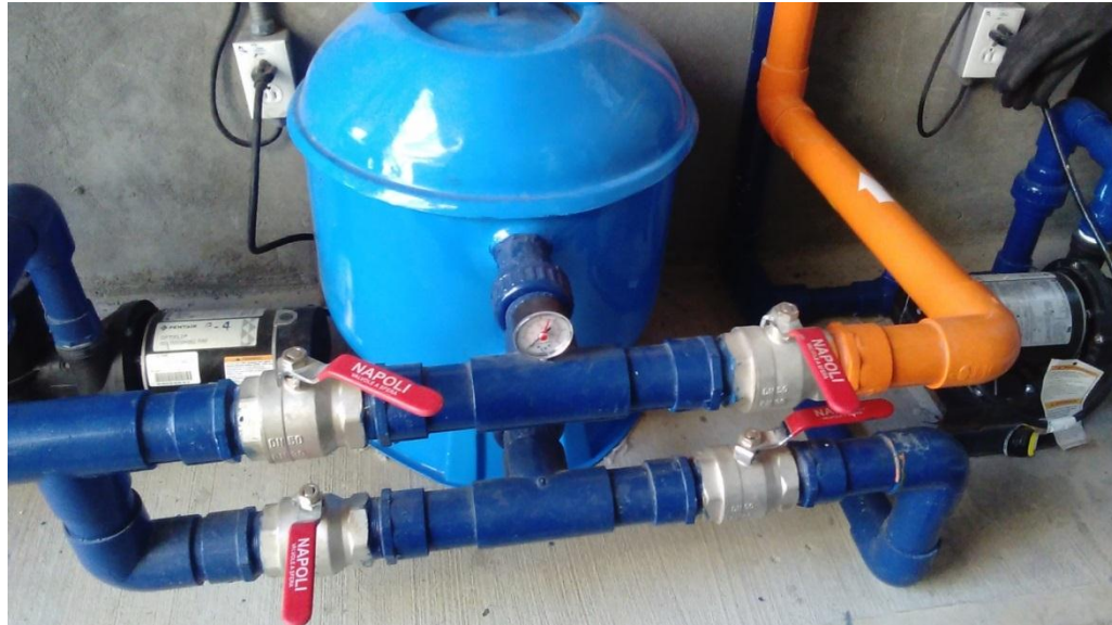
Figura 20. Unidad de filtración.
