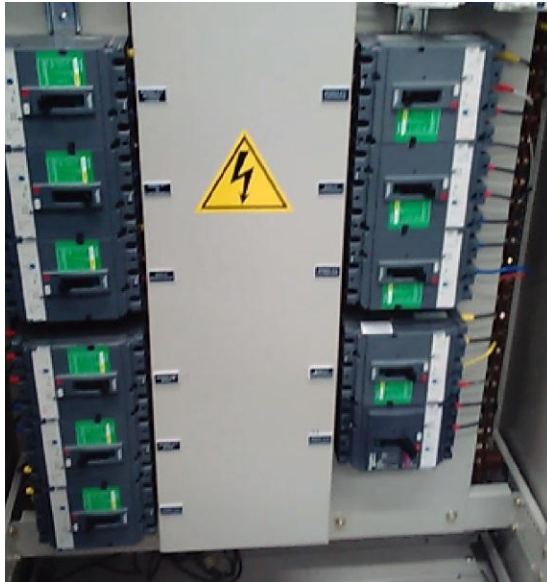
Figura 3. Interior del tablero de control
