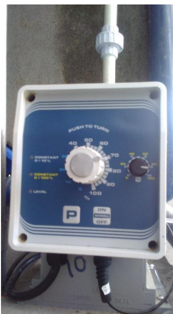
Figura 14. Dosificadora de floculante.
