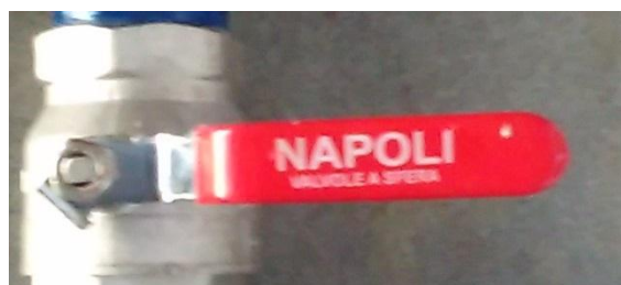
Figura 8. Válvula de entrada a la trampa de grasas
