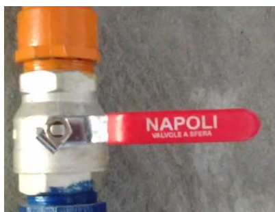
Figura 9. Válvula de entrada a los lechos de secado.
