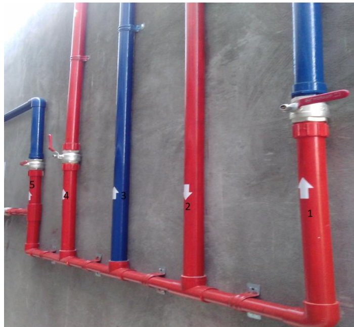
Figura 5. Tubería a la entrada de la planta
