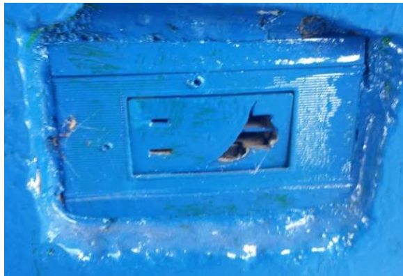
Figura 7. Toma en mal estado
