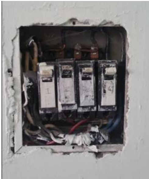
Figura 3. Tablero eléctrico principal
