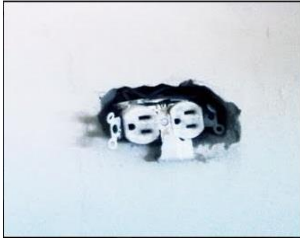
Figura 6. Toma Sin seguridad
