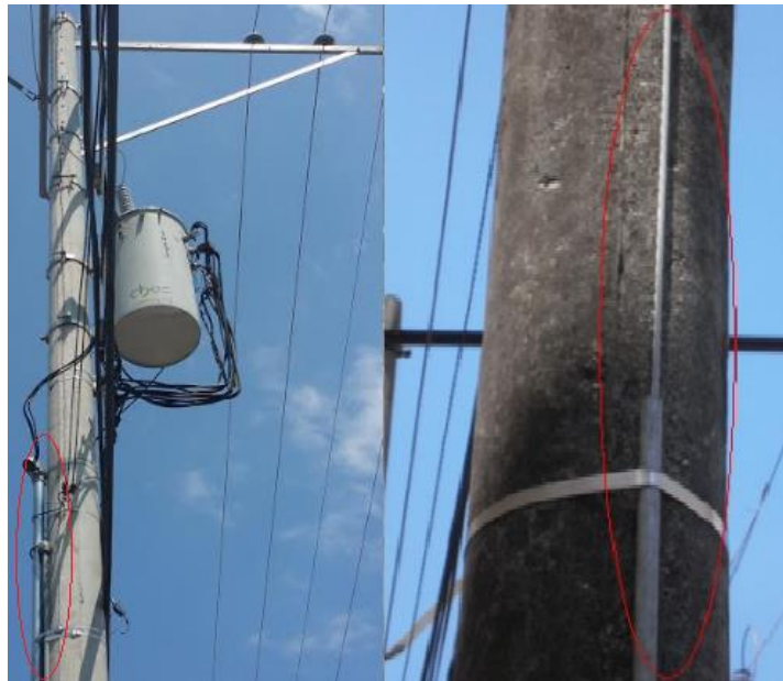
Figura 2. Conductor de puesta a tierra del transformador
