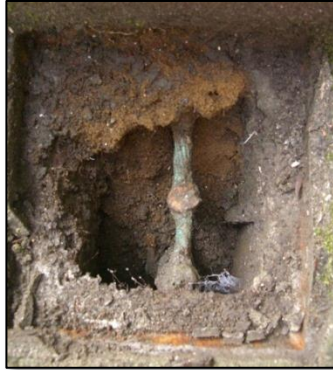
Imagen 18. Estado del SPT del Edificio de Industrial
