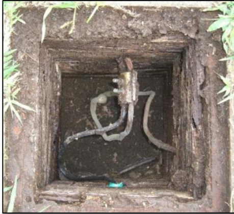
Imagen 3. Estado actual del SPT del Edificio de Eléctrica
