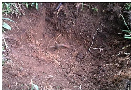
Imagen 5. Estado actual del SPT del Edificio de Eléctrica
