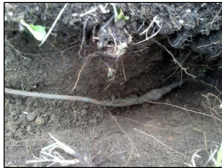
Imagen 26. Estado del SPT del Edificio de Educación.
