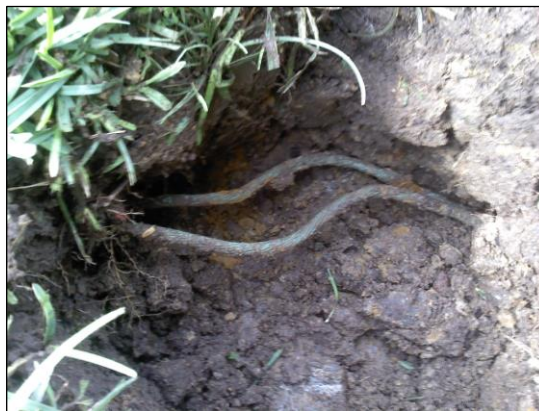
Imagen 7. Estado actual del SPT del Edificio de Ciencias Básicas
