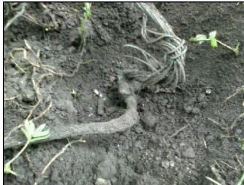
Imagen 24. Estado del SPT del Edificio de Educación.
