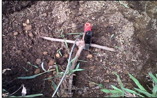
Imagen 15. Estado del SPT del Edificio de Mecánica
