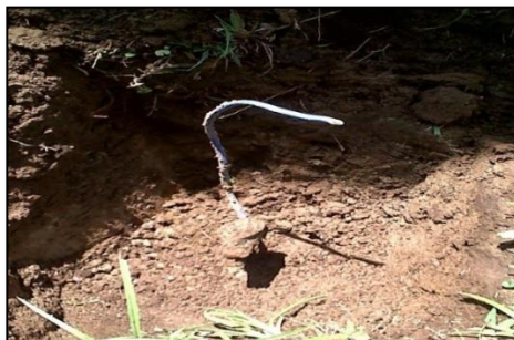
Imagen 49. Estado del SPT del Edificio de Medicina.
