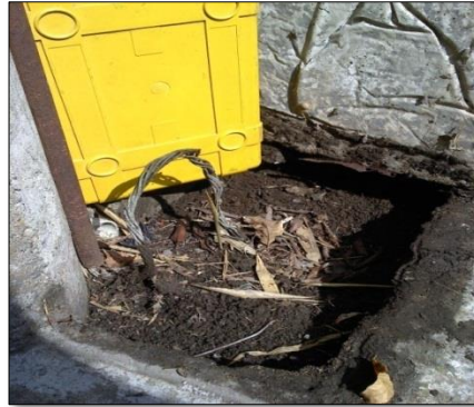
Imagen 12. Estado del SPT del Edificio de Ciencias Básicas
