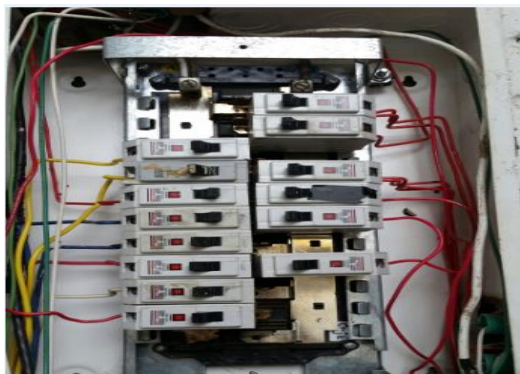
Figura 8. Barrajes tablero cancha
