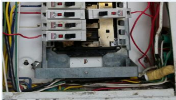
Figura 10. Barrajes tablero cancha
