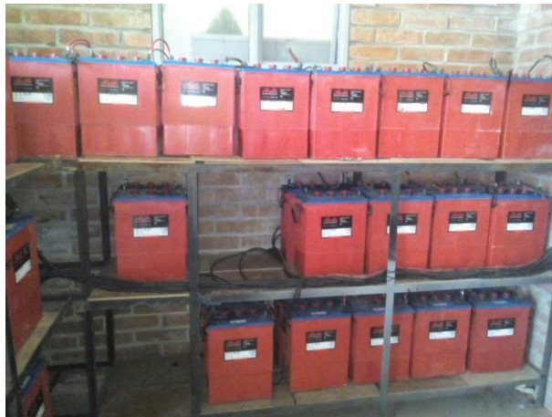
Figura 7. Banco de baterias ROLLS
