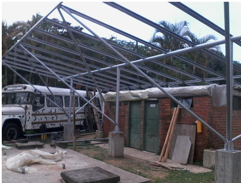
Figura 2. Adecuación del sistema.
