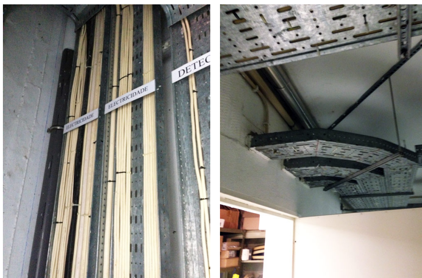
Figura 51 - Courette e Calha técnica no edifício da UMa (da esquerda para a direita)
