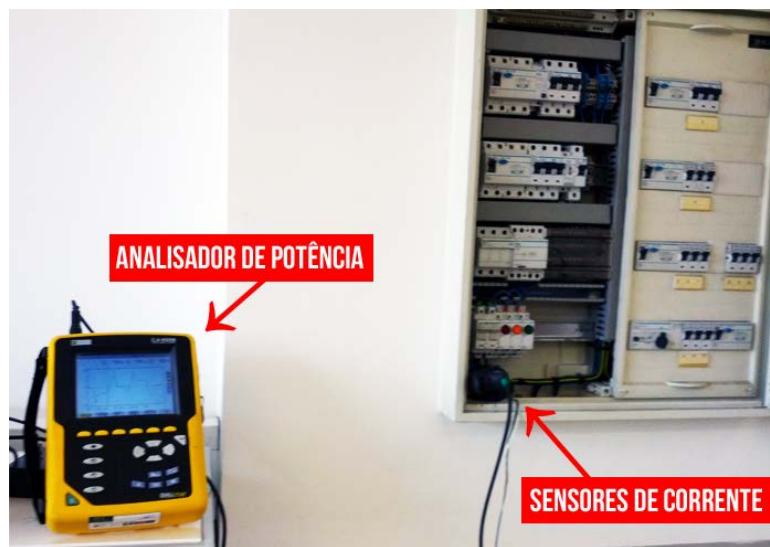
Figura 82 - Analisador de Potência com o sensor ligado ao quadro eléctrico ao mesmo tempo que o sensor de corrente do dispositivo de aquisição de dados para efectuar a calibração
