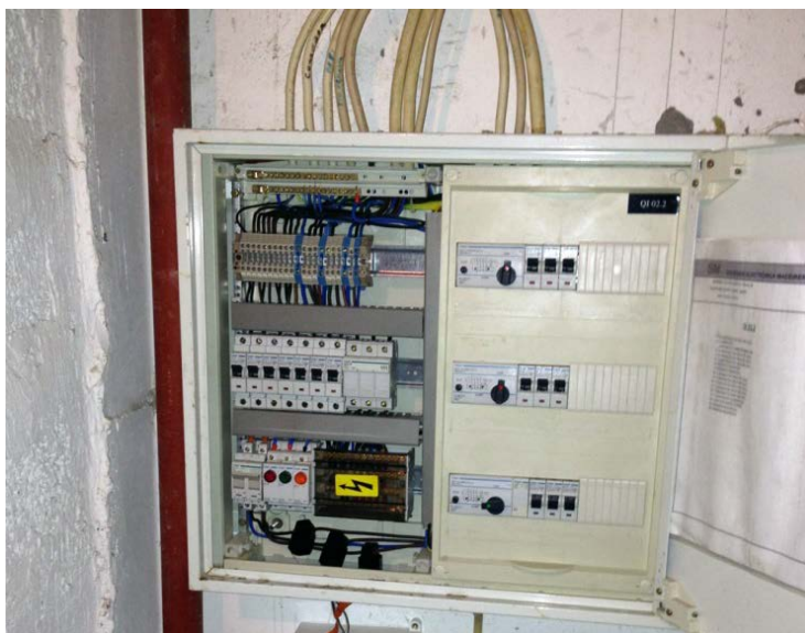
Figura 48 - Quadro eléctrico parcial
