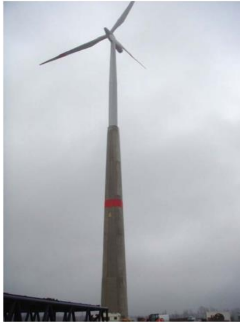
Figura 21 - Torre híbrida com 2.3 MW fabricada pela Advanced Tower Systems [21]
