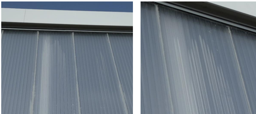
Disse billeder er fra referencen: den skrå facade på ambulancemodtagelsen på hospitalet i Nuuk. Der er tydelig kondens i kanalerne på nogle af pladerne. Det tyder på, at den forseglende tape enten er utilstrækkelig, eller ikke er udført korrekt. Det gør knap så meget her, fordi det er et mat plade på en garage. Men på prøvehusets klare tag vil det være meget synligt. [Foto: Tove Lading]
