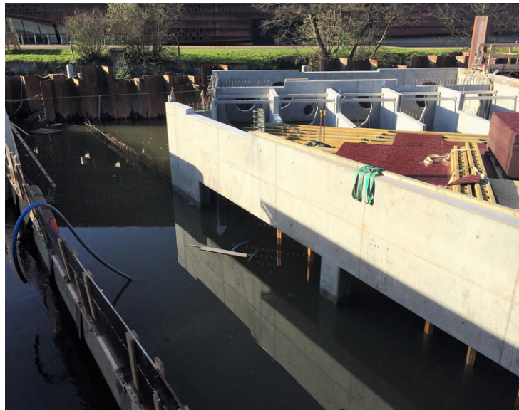
Oversvømmelse af byggegruben pga. bundbrud.
